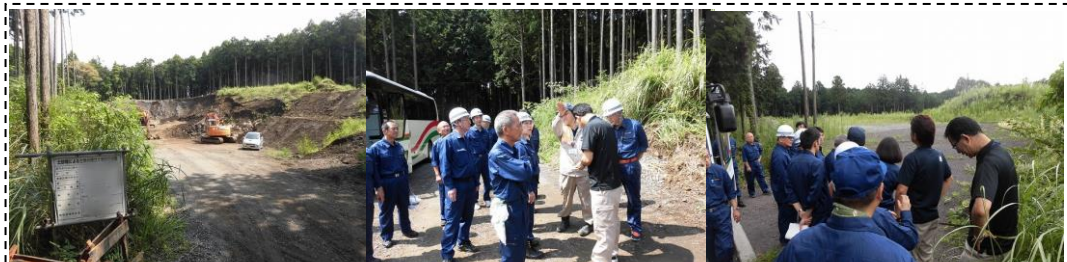
富士山麓の違法土砂埋立て現場を視察(8/30)・・・今年になって目立ち始めた土砂の違法埋立ての現場を議員有志で視察しました。写真左は適正な手続きの、右が違法な現場です！
